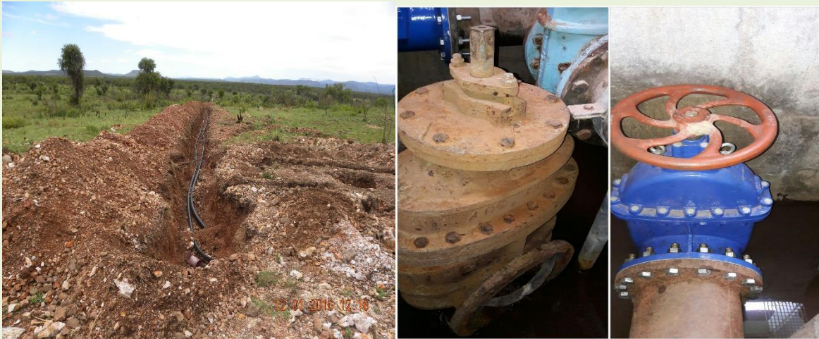
Vingerkraal pump line.
